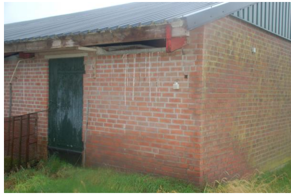
meststrepen op muur
