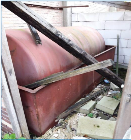
foto 9: Bovengrondse tank loods 4 (zuidwestelijke richting)
