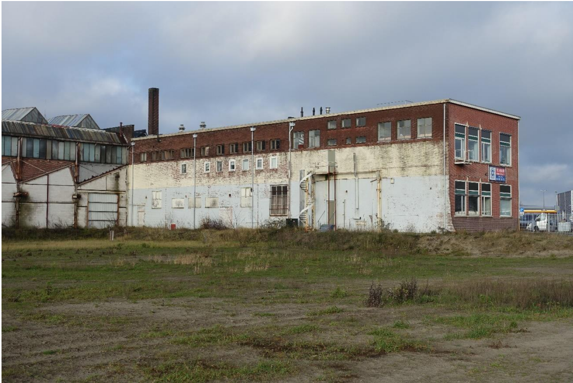
Het dak aan de rechterzijde. Links van de schoorsteen een punt van de lichtkap.
