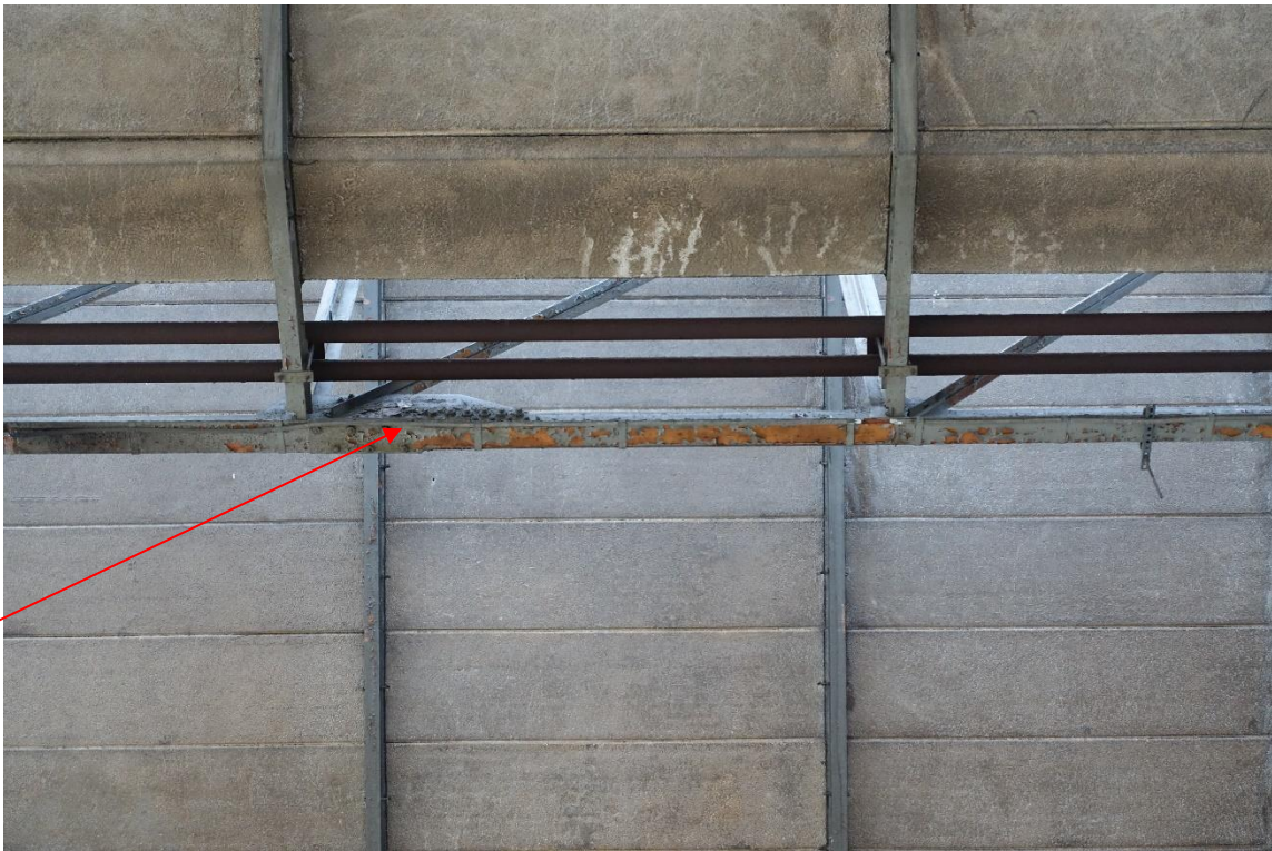
Bij de pijl de koppeling van de twee delen van de vakwerkliggers. Met bouten is een plaat aan de hoeklijnen vastgezet.
