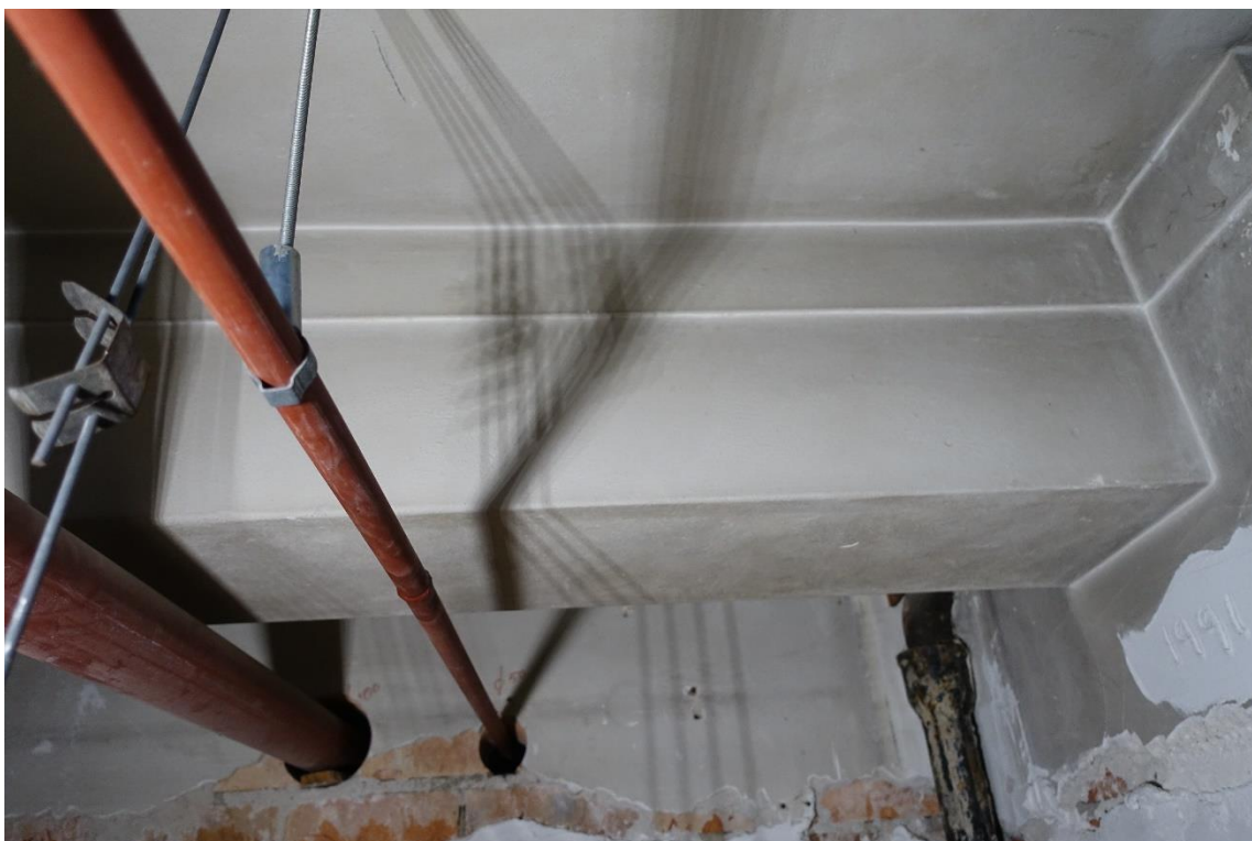
De betonnen kapconstructie van de linker uitbreiding. Deze is boven de verlaagde plafonds zichtbaar. De afwerking met pleisterwerk geeft aan dat het geheel oorspronkelijk in het zicht was gelaten.
