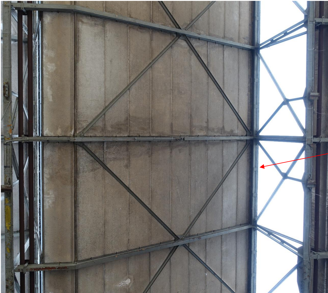
Uitvergroete foto van de binnenzijde van beide dakvlakken en de vakwerkliggers. De windverbanden zijn tussen de liggers gebout. Bij de rode pijl één van de gelaste plaatjes die beide U-profielen aan de bovenzijde van de vakwerkligger verbindt.
