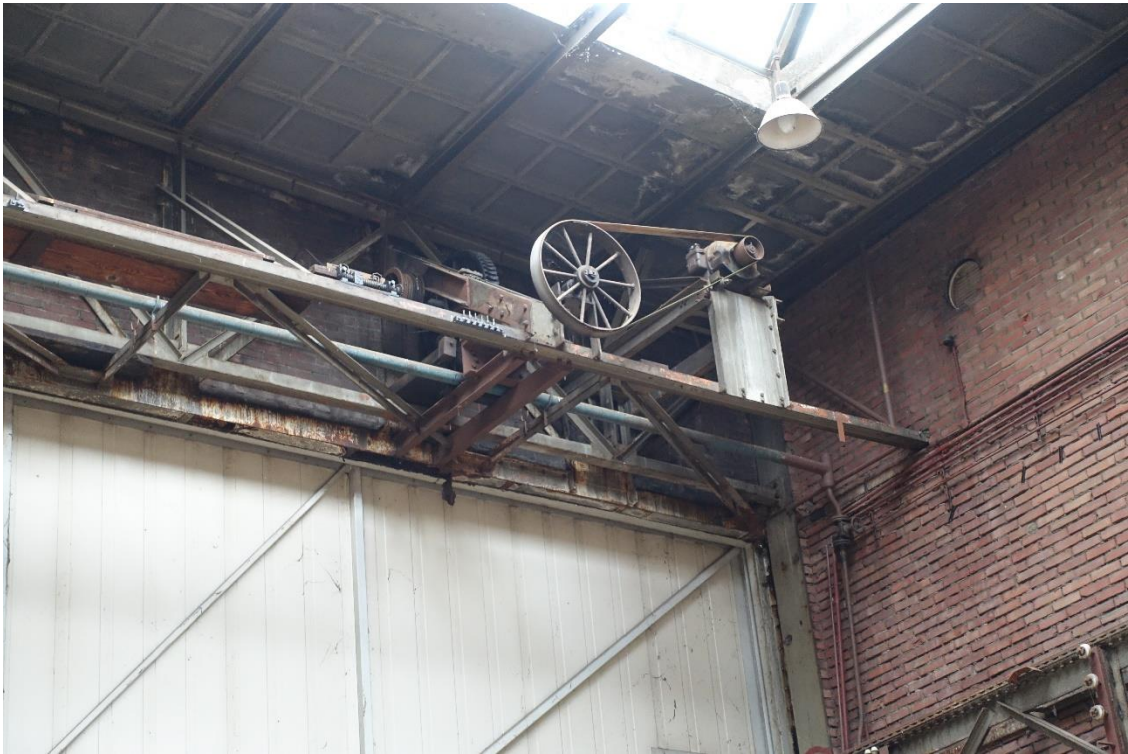
De aandrijving van het hefmechanisme voor het paneel dat de opening van de kraanbaan sluit. Het geheel is oorspronkelijk.
