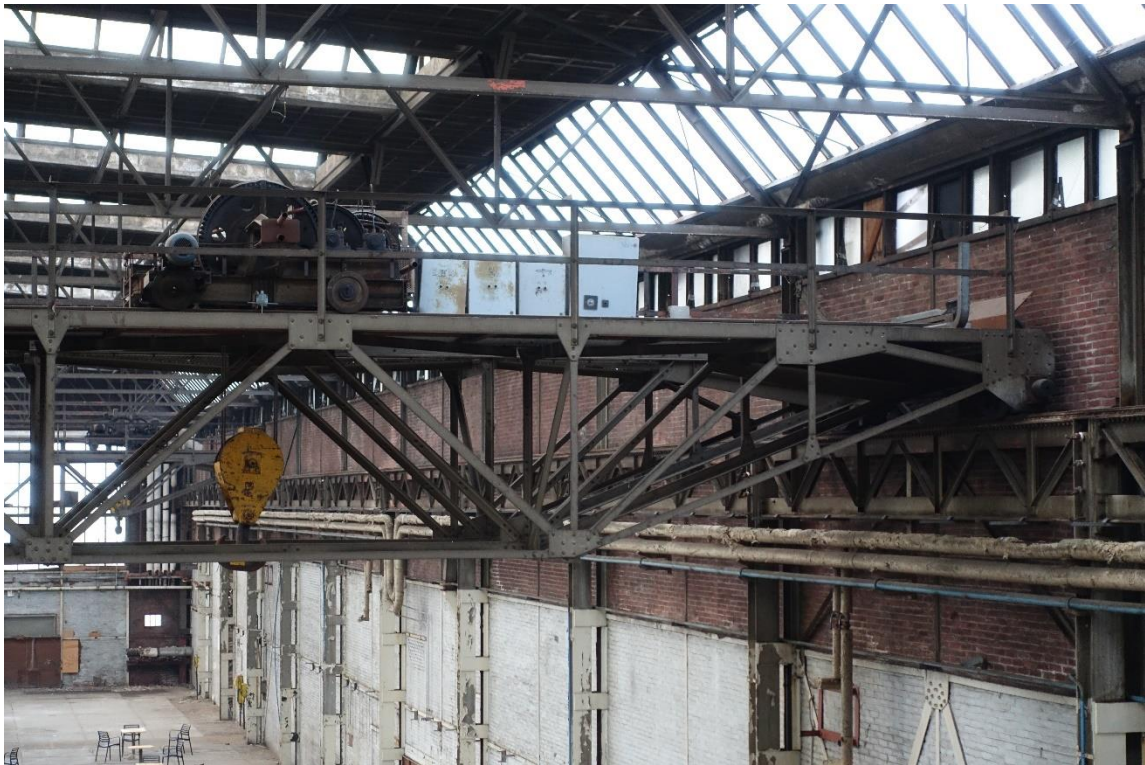
De rolkraan in de oostelijke hal, de overspanning van de hal wordt gevormd door de onderspannen liggers waarbij de verbindingen met klinknagels zijn vastgezet.
