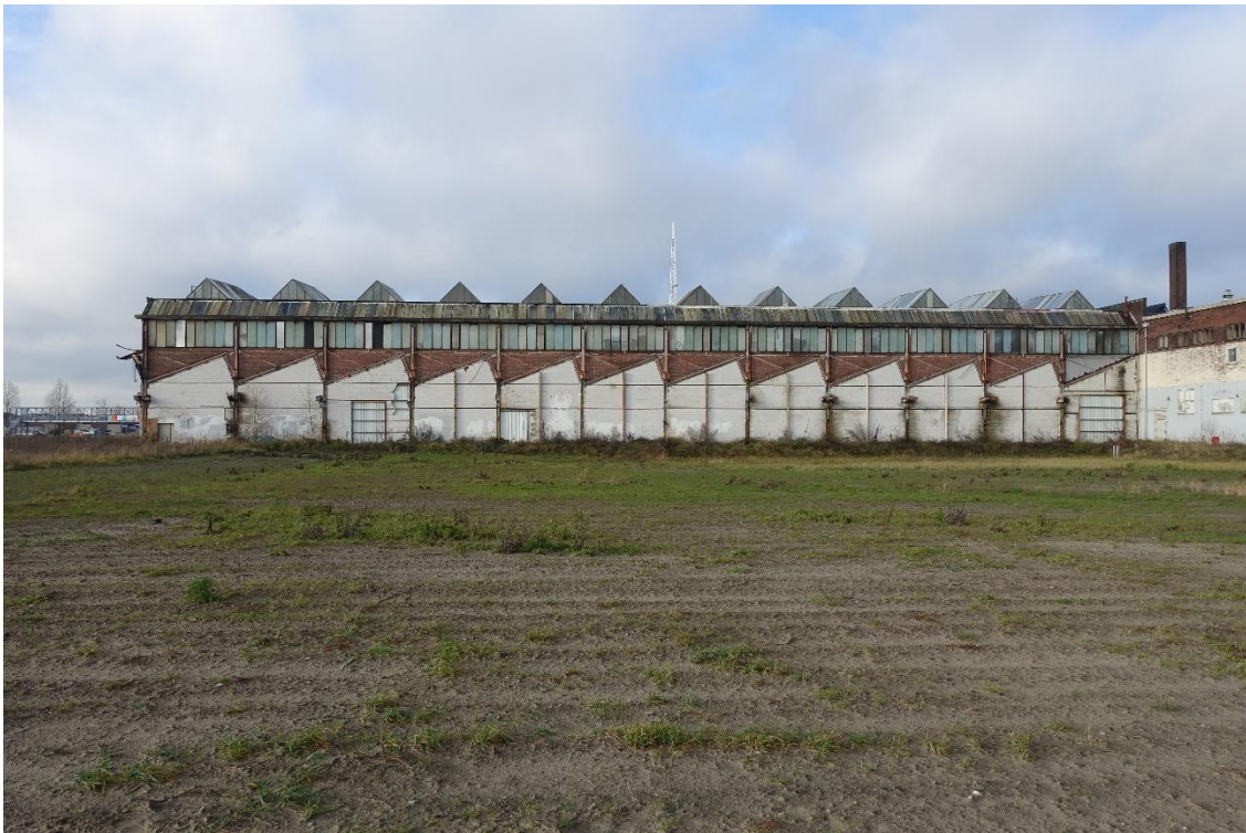
De oostelijke gevel. Deze heeft een geheel regelmatige opbouw. Het werk in rode baksteen is oorspronkelijk, het witte werk van blokken gasbeton onder de daklijn betreft een tijdelijke dichtzetting na de sloop van de aanliggende hallen. Het bovenste deel van de gevel betreft een lichtstraat met draadglas tussen stalen roeden.
