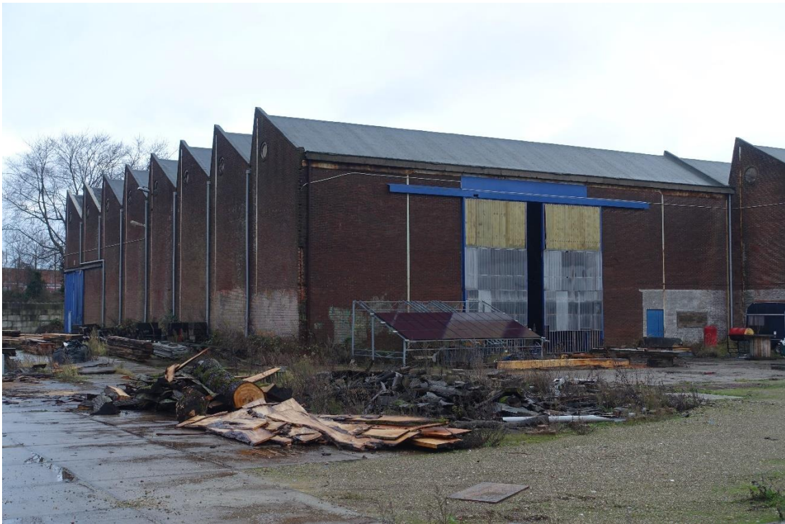
De korte westelijk hal, van acht traveeën met de achtergevel en westelijke zijgevel. De opbouw en indeling zijn gelijk aan die van de oostelijke hal.
