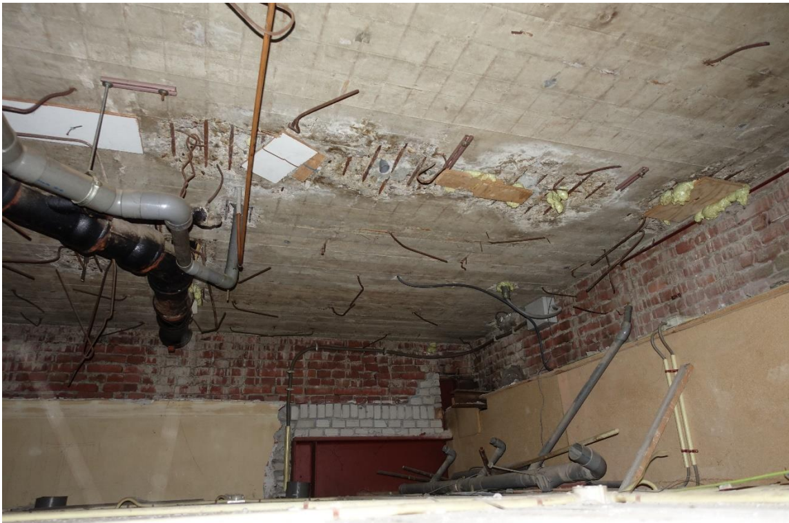
De ruimte boven het verlaagde plafond van de hal. Tegen de wanden is het oorspronkelijke pleisterwerk zichtbaar. Dit stopt bij een lat die de rand van het plafond vormde. Dit hing aan de ingestorte ijzers.
