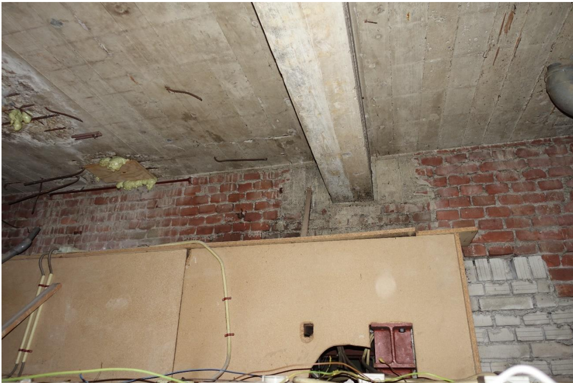
De onderzijde van de verdiepingsvloer boven het verlaagde plafond van de entree. Het steeds dikke binnenblad is zonder verder verband opgetrokken. De balk is conform tekening uitgevoerd. Aan de linkerkant is de wapening vrij komen te liggen nadat er doorvoeren zijn aangebracht.
