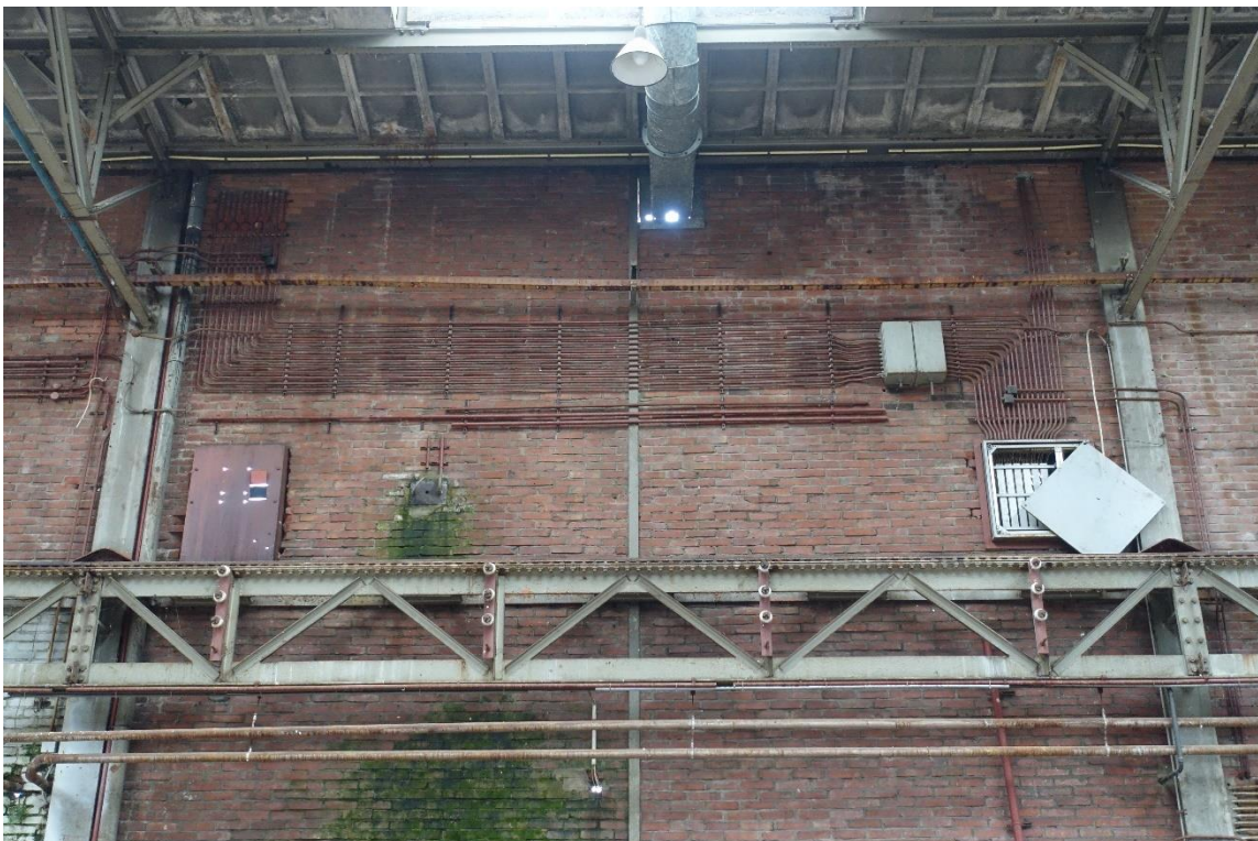
Een voorbeeld van de vele installaties en bedrading die er op de wanden nog aanwezig is, hier op de westelijke gevel van de westelijke hal.
