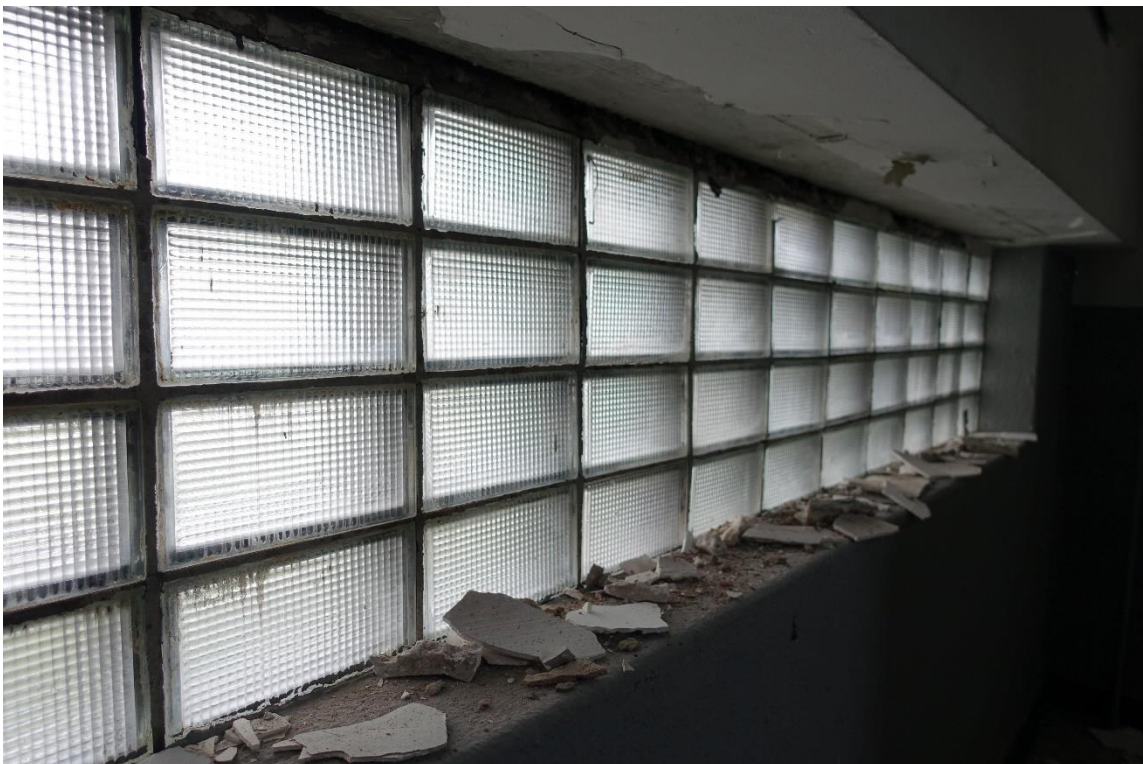
De onderste strook glazen bouwstenen in het trappenhuis gezien vanaf de binnenzijde. Er kon geen type van de stenen worden vastgesteld. Ze zijn gelijk aan die in de kelder.
