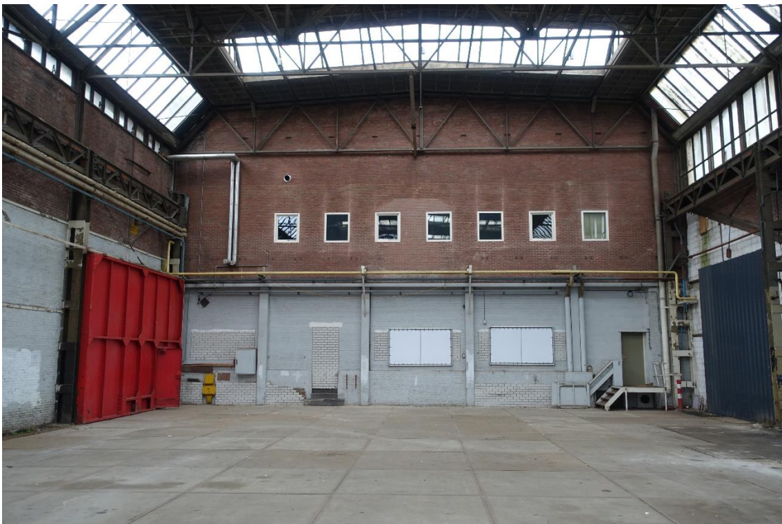
De gevel van het kantoor in de oostelijke hal. De rechter deur verbindt met de kelder.
