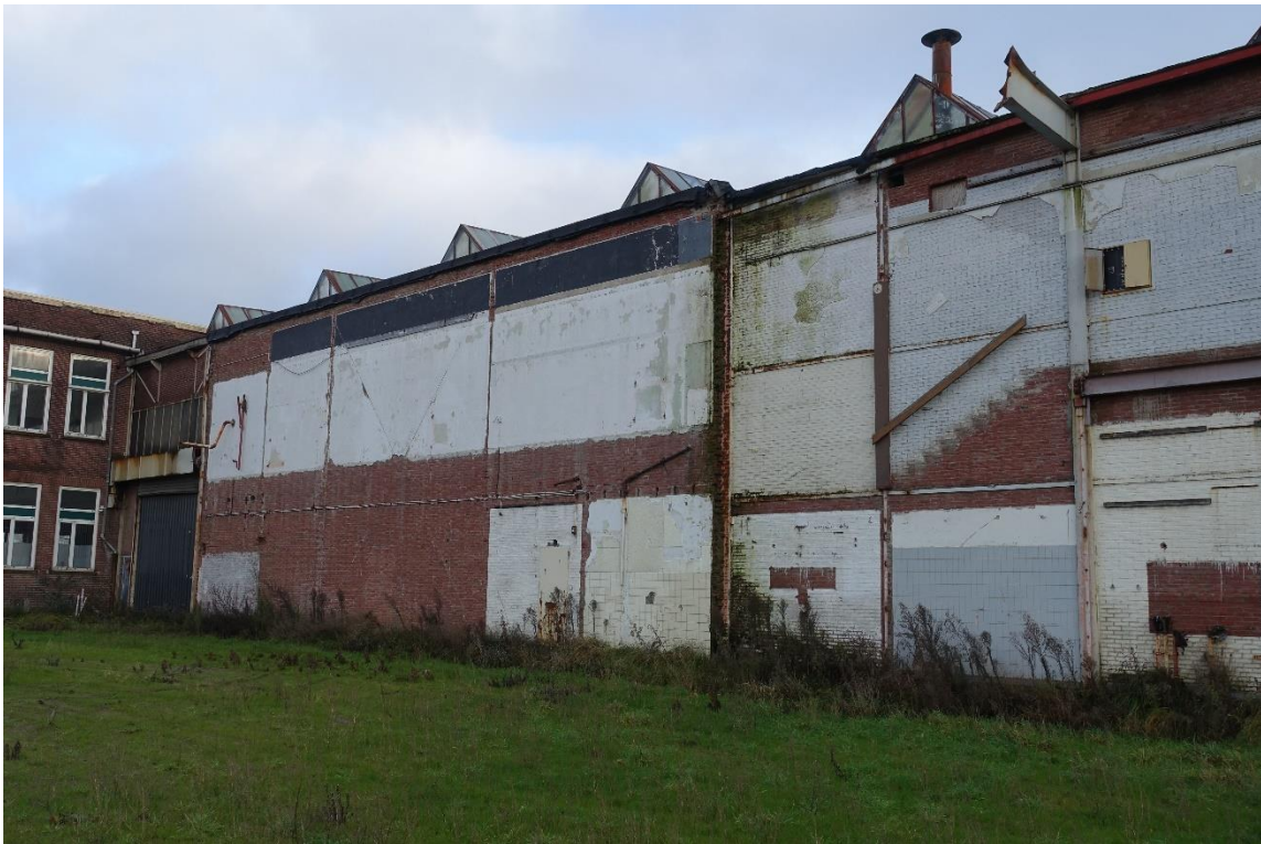
De eerste vijf traveeën van de westelijke gevel. De eerste travee betreft de toegang tot de hal van buiten, ook de spoorlijn liep hier naar binnen. De tweede, derde en vierde travee zijn van een steens klampmuur voorzien, waarschijnlijk om zonder het geluid van de werkzaamheden in de hallen te kunnen werken. In de vijfde travee is er een trapopgang zichtbaar, ook de leuning is nog aanwezig.
