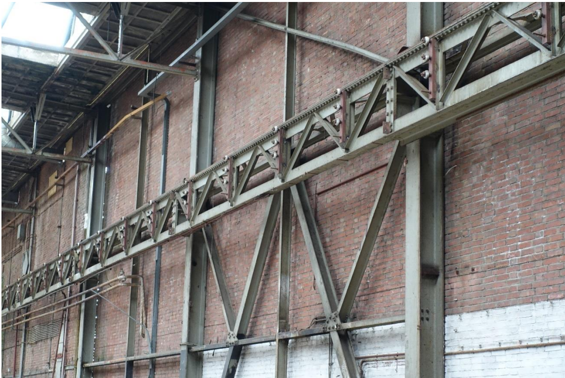
De rolbaan aan de westelijke zijde van de westelijke hal. Deze is met bouten bevestigd aan klossen die op de stijlen zijn gelast. Aan de porseleinen knoppen is de bedrading bevestigd.
