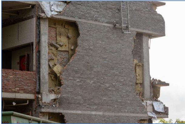
Foto 05: het pand met de stenen wanden met tochtgaten.
