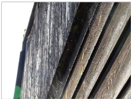
Foto 13: Houten schuur (geen openingen langs dakrand en betimmering).
