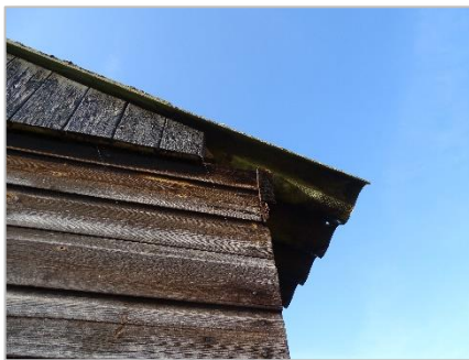
Foto 14: Houten schuur (geen openingen langs dakrand en betimmering).
