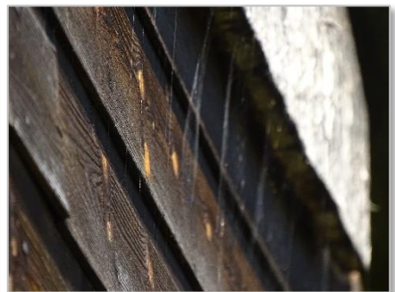
Foto 15: Houten schuur (geen openingen langs dakrand en betimmering).
