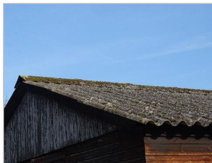
Foto 17: Houten schuur (geen openingen langs dakrand en betimmering).
