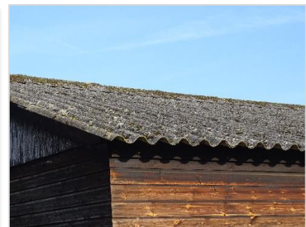
Foto 18: Houten schuur (geen openingen langs dakrand en betimmering).
