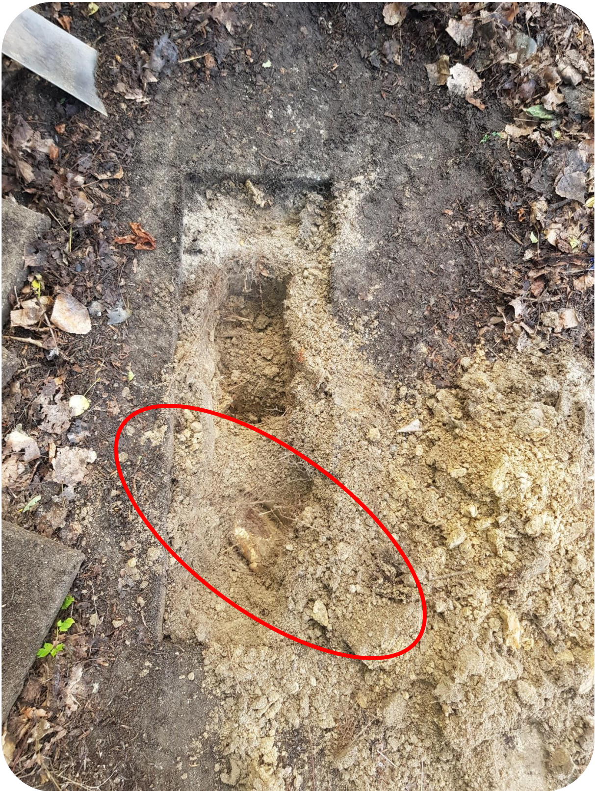
Foto 14: 10 cm dikke wortel onder tegelverharding westzijde boom 1
