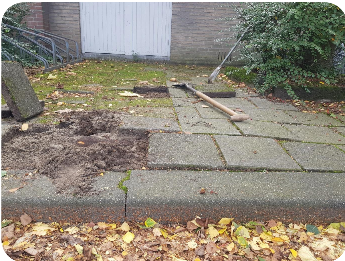
Foto 24: opdrukveroorzakende wortels in verharding bij boom 12
