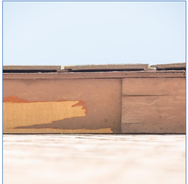
Foto 06: ruimte tussen de gevelbetimmering en muur
