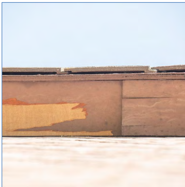
Foto 06: ruimte tussen de gevelbetimmering en muur
