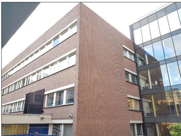
Figuur 6. Gedeelte naast hoofdingang met open stootvoegen
