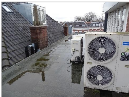
Foto 26: Dak met ventilatoren.
