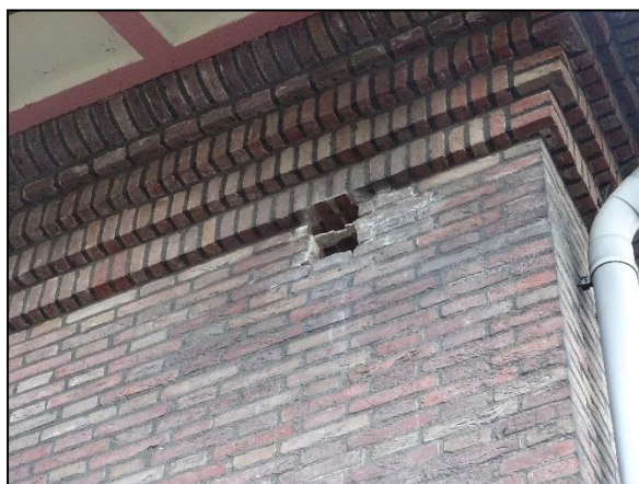
Figuur 10. Geschikte gaten in de buitengevel van het noordelijk deel van het pand.
