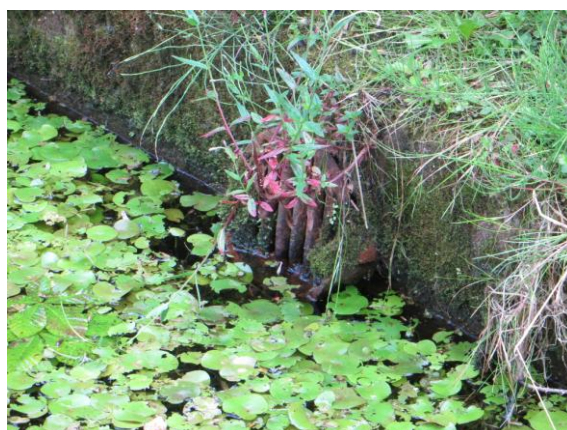
Afb. 1.33: In de zuidelijke vijverrand bevindt zich een metalen overstort.
