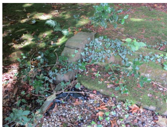
Afb. 1.23: Gebrekkige aansluiting van het grindpad (grind op worteldoek) met betonnen kantopsluiting op de gemetselde traptreden nabij de tuinmuur. Alle vier de trappen in de zijtuin zijn onderhevig aan verzakking.
