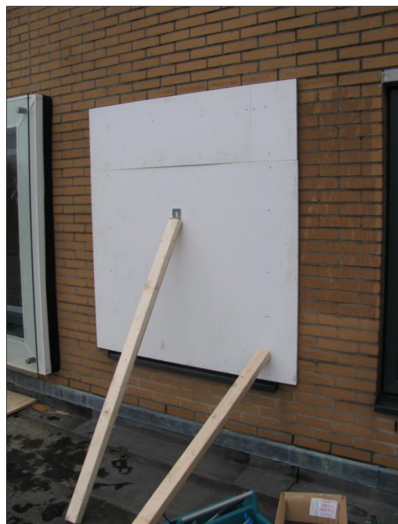
Foto II.4 Provisorische afdichting tweede raam
