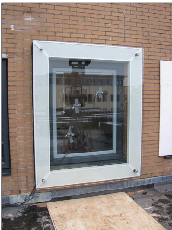
Foto II.3 Aanzicht glazen gevelgeluidscherm
