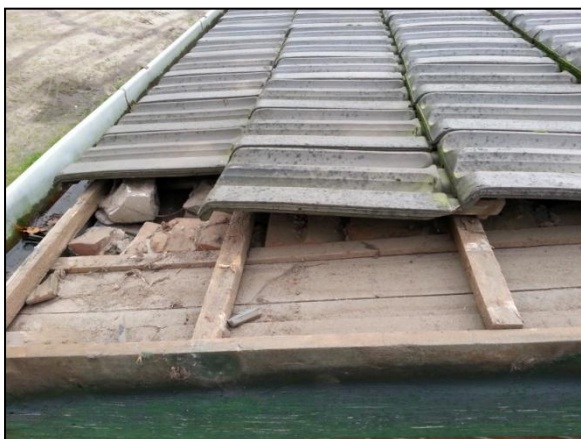
Figuur 9. Gelichte dakpannen langs westzijde noordelijke schuur.
