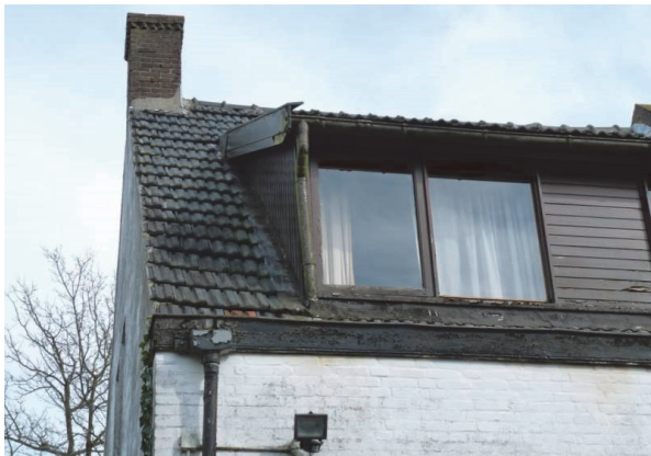
Fig. 9. De achterzijde van het dak, met her en der kieren en gaten, geschikt als invliegopening voor vleermuizen.
