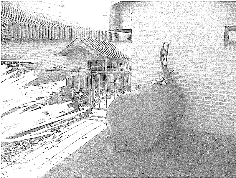
Foto 7: bovengrondse olietank locatie Lage weg 17
