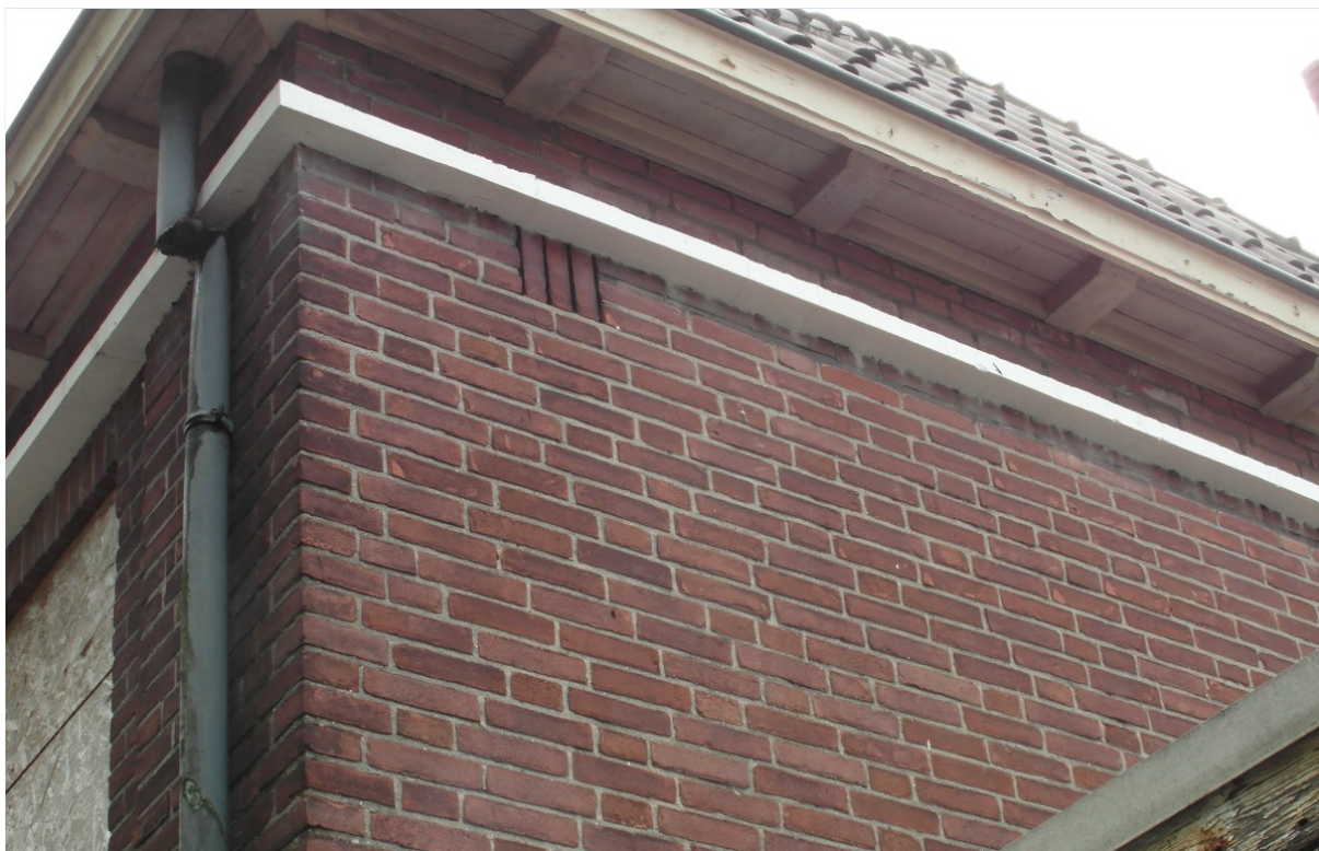
Foto 2 afgesloten roostervoegen huisnummer 104.
