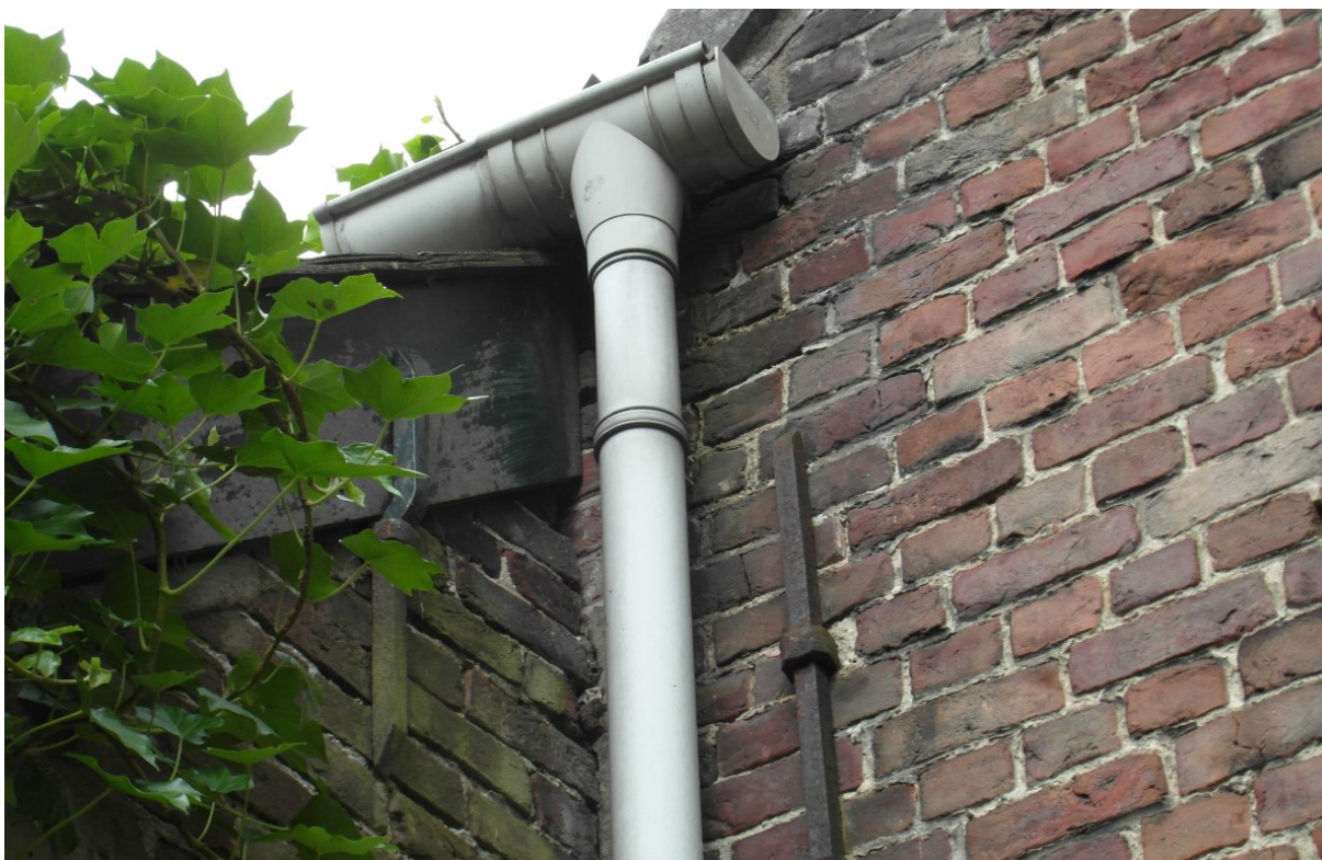
Foto 4 afgesloten kieren huisnummer 126.
