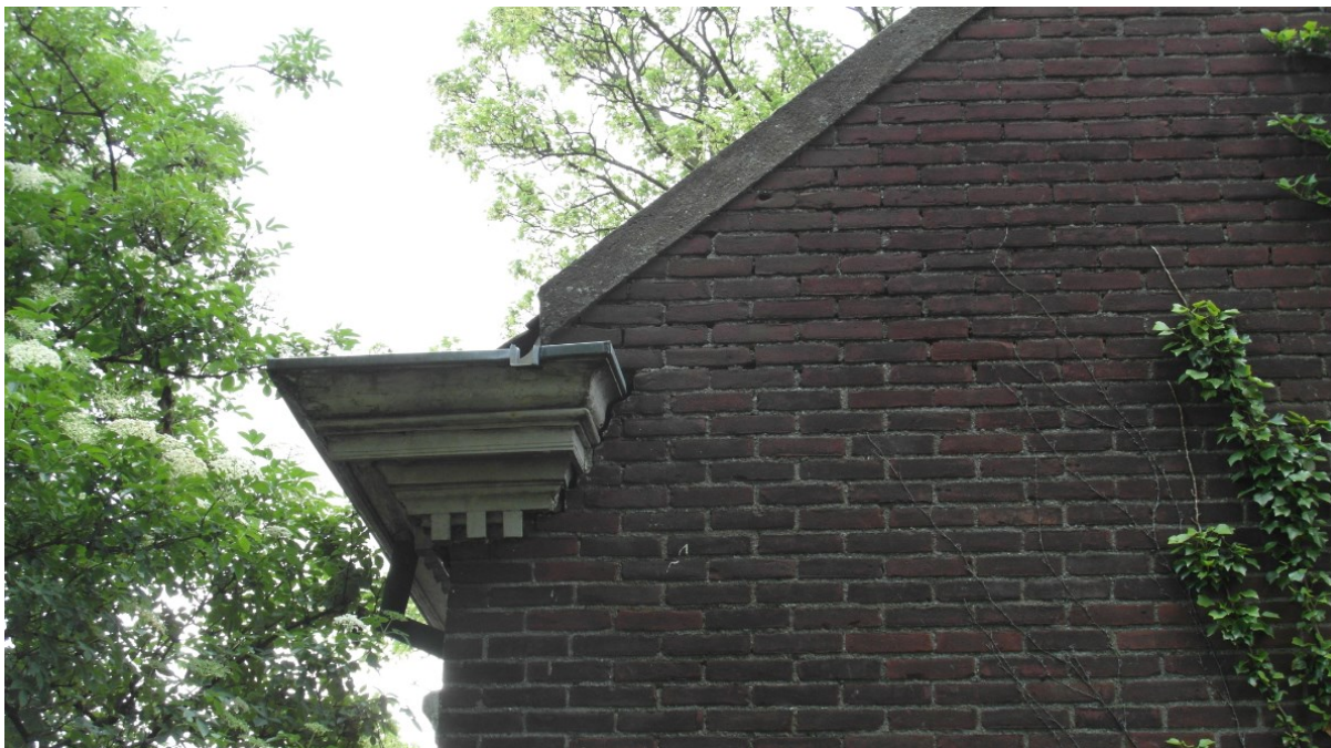
Foto 3 afgesloten kieren huisnummer 126.
