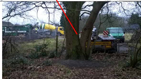
Boom (Eik) net buiten de grens van het plangebied. De aan te leggen weg komt er dicht bij de boom te liggen .gevaar op de wortels (druk)
