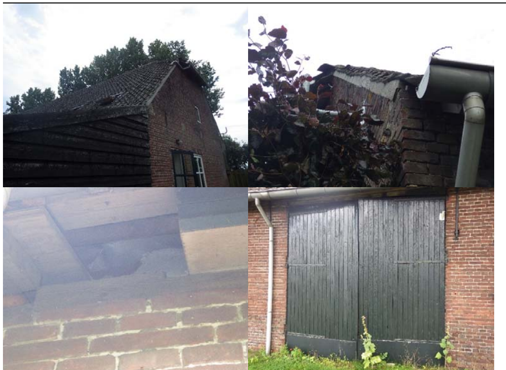
Figuur 3.1 Impressie van de ruimtes die door vleermuizen gebruikt zouden kunnen worden als verblijfplaats of die mogelijk toegang verschaffen tot de spouwmuren. Boven de kopgevel van de woning waarop de openingen tussen de dakpannen zichtbaar zijn, linksonder de schade aan de gevel van de woning onder het dak en rechtsonder de dichtgetimmerde staldeur
