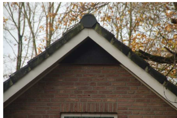
vleermuiskast aan kopgevel garage Kempseweg
