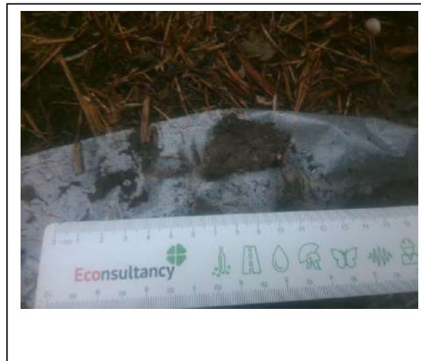
Foto 2. Asbesthoudend materiaal asbestinspectiegat B11
