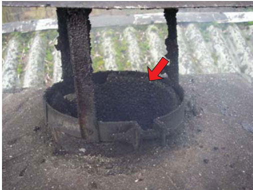
Foto 1; Woonhuis; asbestcement buis in rookkanaal. (M1)
