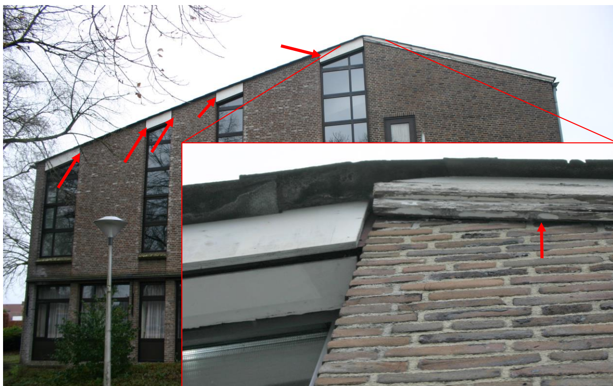
Figuur 4.4.4. In de zuidgevel zijn verschillende kierende betimmeringen aanwezig. Hierdoor kunnen vleermuizen de achterliggende spouw bereiken.
