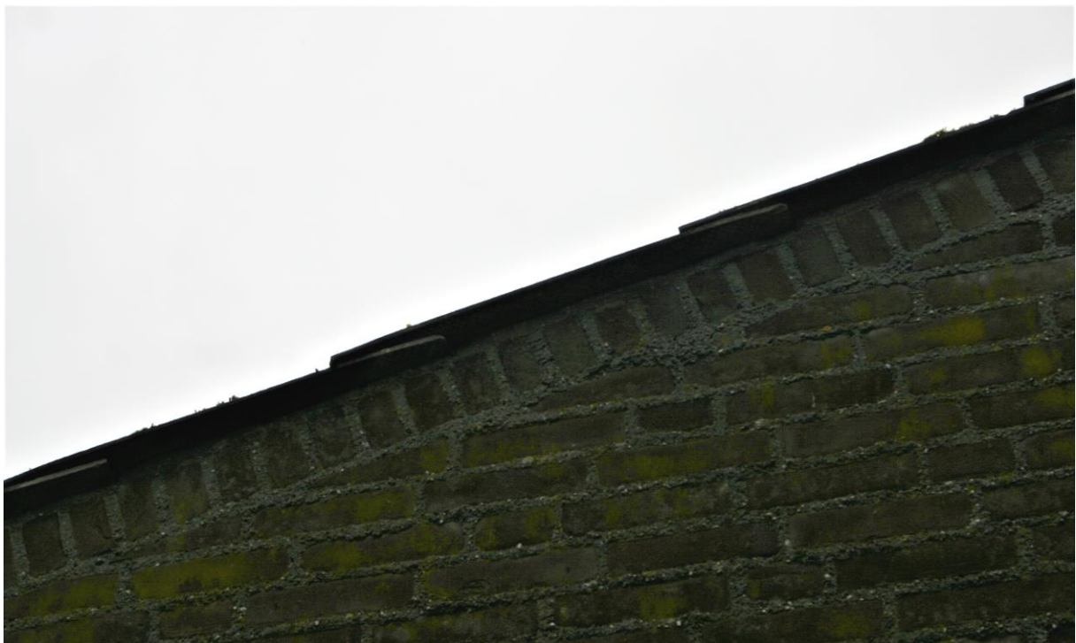
Figuur 4.4.2. De uit golfplaten bestaande daken zijn op de zijgevels afgestreken met specie. Hier is dus geen plaats voor gierzwaluwnesten of vleermuisverblijven.
