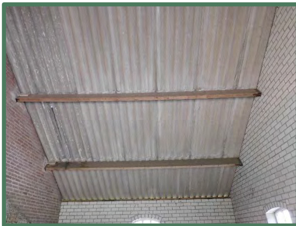
Niet geïsoleerd dak
