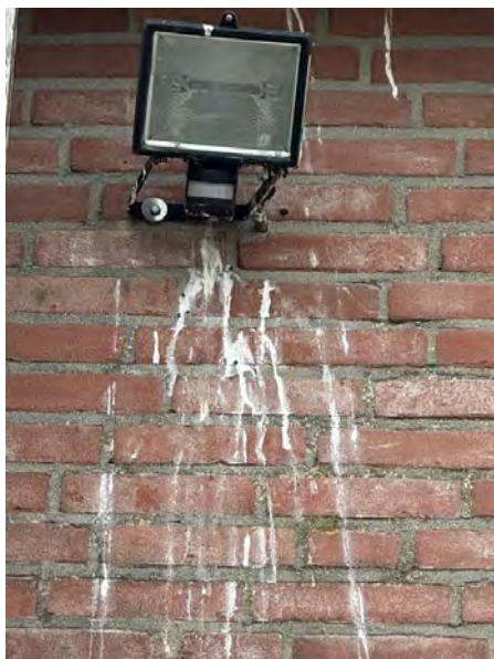
Figuur 6b: Uilenmest op achterzijde gevel gebouw 6.
