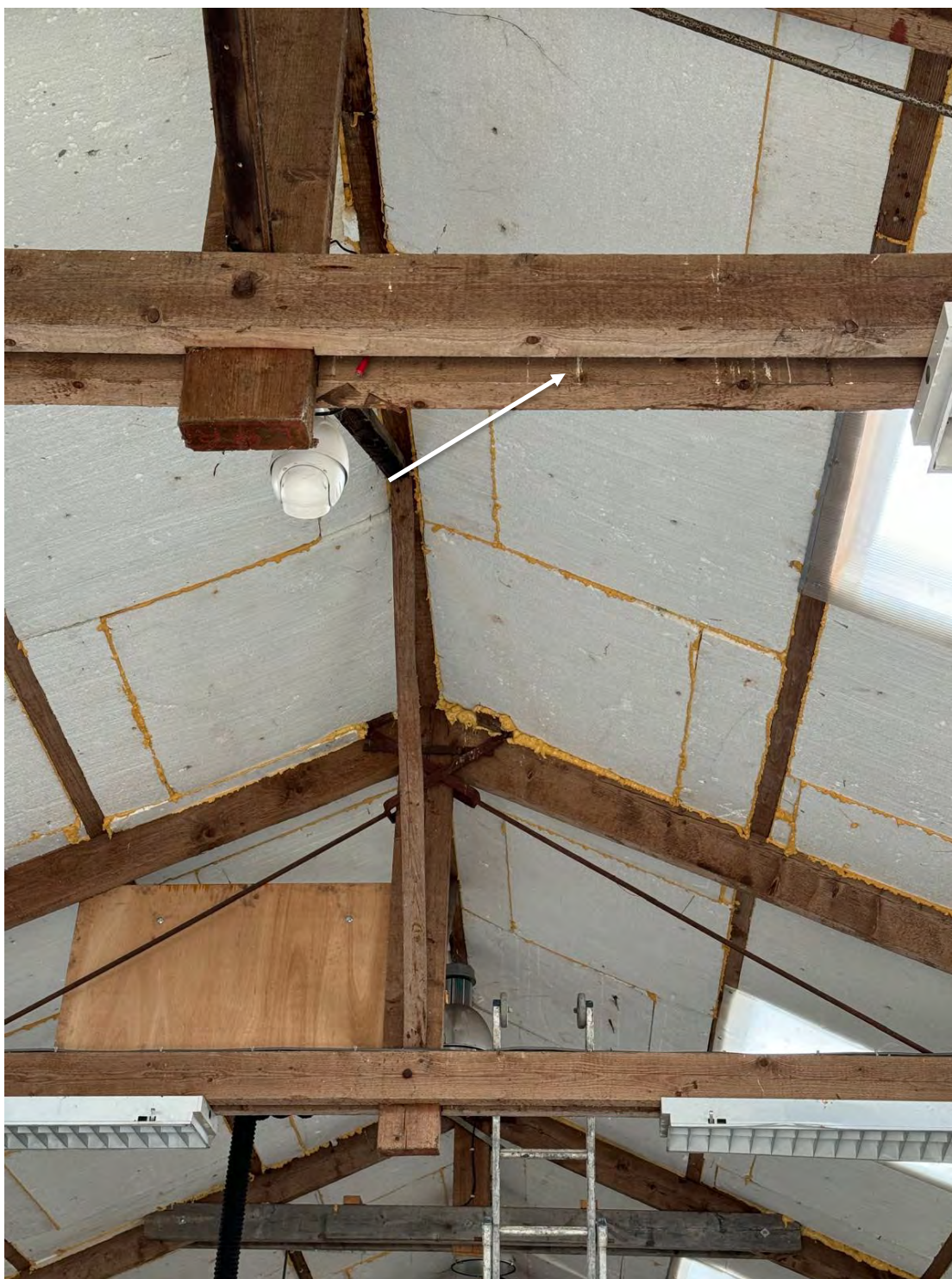
Figuur 5k: Oude mestsporen van uil (kerk of steenuil). Er zijn géén mestsporen op de grond aanwezig.
