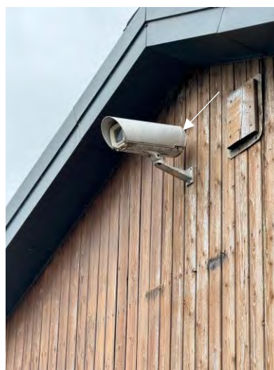
Figuur 5h: uilenmest op camera gebouw 3.
