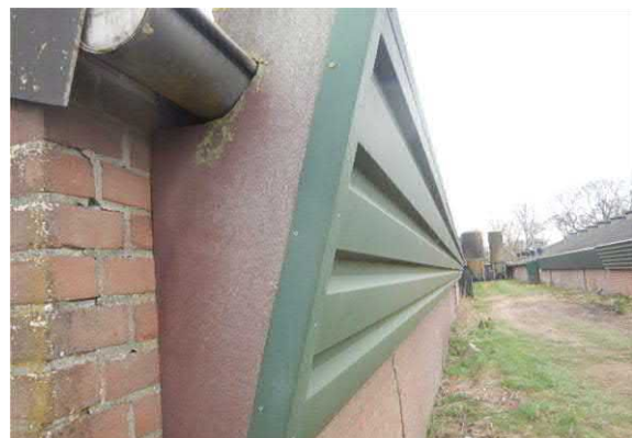
Ventilatiebakken van hout en damwand
