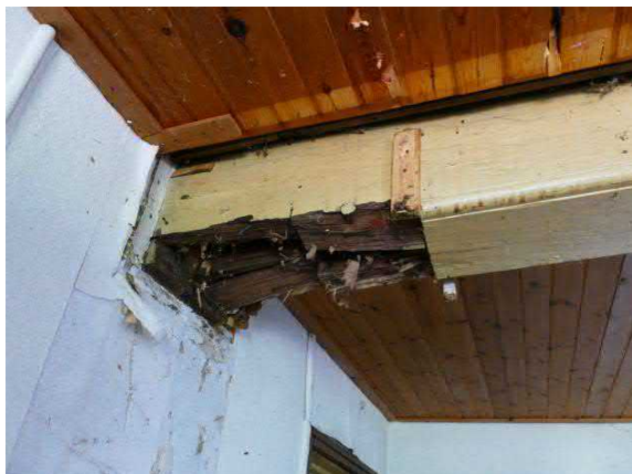
Figuur 66. Gesloopte schoor van de moerbalk. Toen de scheidingsmuur met de gang werd gebouwd, was de stijl met schoor overbodig geworden.
