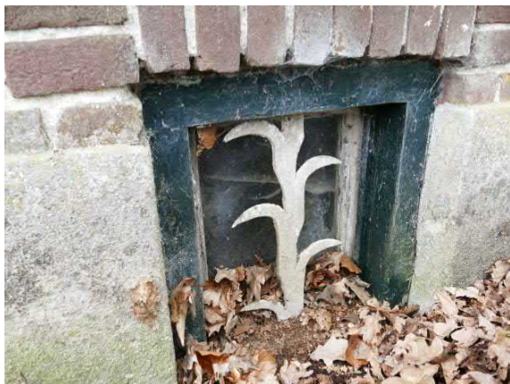
Figuur 47. Kelderraam met curieus diefijzer
