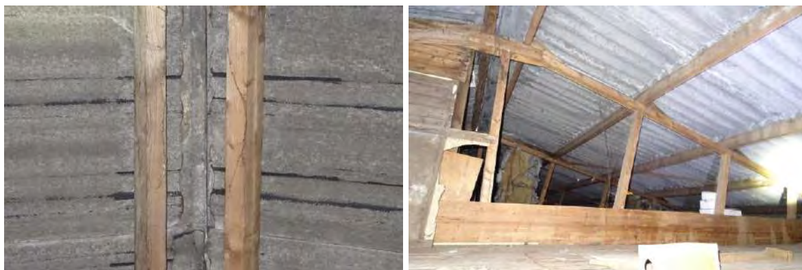
Afbeelding 7 en 8: Daken van de stallen zonder dakbeschot. Afbeelding 7 is Hoekstraat 4 en afbeelding 8 is Schepersdijk 1 te Venhorst. Bron: R.J.L. Bijvelds 20-05-2021
