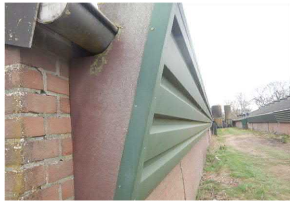
Ventilatiebakken van hout en damwand
