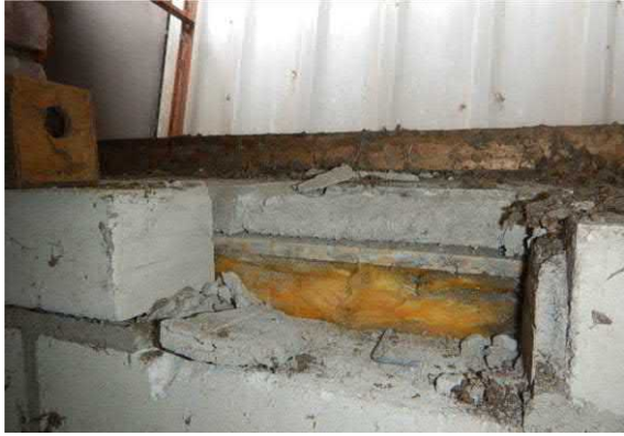
Spouwdichtlegging met hout
