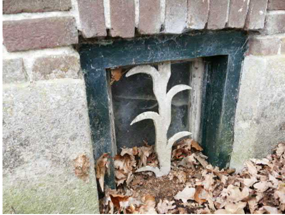
Figuur 47. Kelderraam met curieus diefijzer
