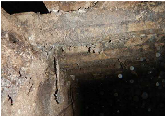
Betonnen roosters op gemetselde putten
