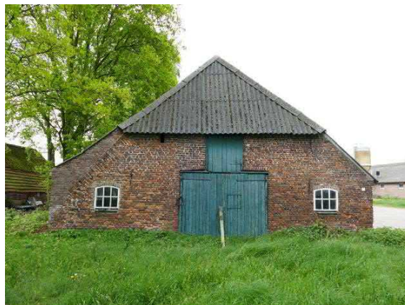
Figuur 12. Eindgevel heeft bij de aansluiting aan oostgevel geen vlechtingen
