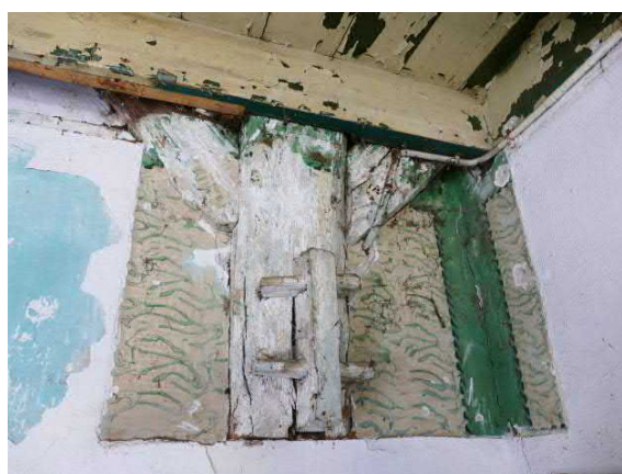
Figuur 63. De afgezaagde stijl van de moerbalk was in de keuken afgetimmerd maar is ter gelegenheid van Open Monumentendag weer zichtbaar gemaakt.
