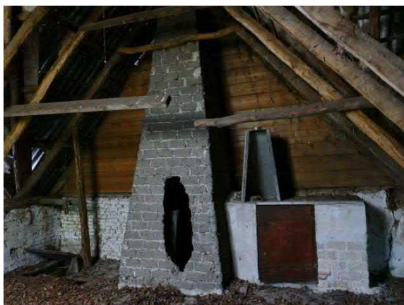
Figuur 29. Het schoorsteenkanaal zal van na 1925 dateren. De brandgevel loopt achter het schoorsteenkanaal door en is afgedekt met een muurplaat.
