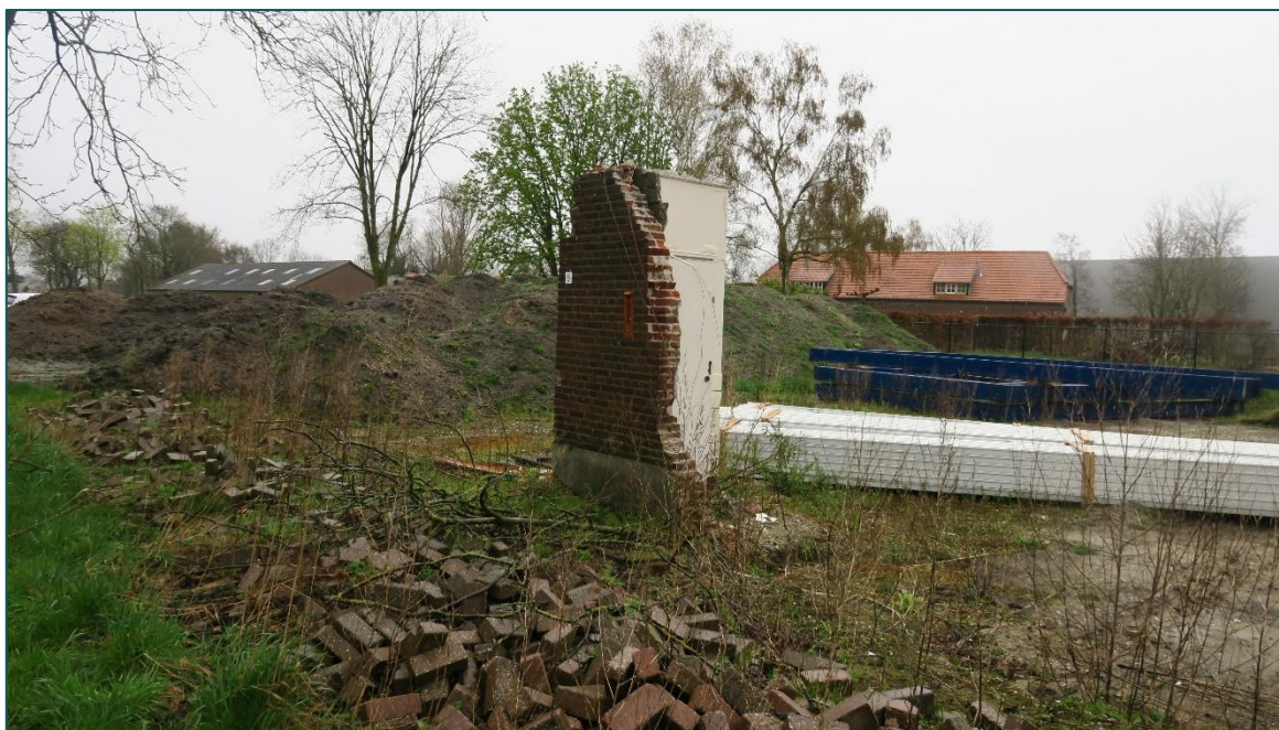
Figuur 2 Restant van de reeds gesloopte woning.
