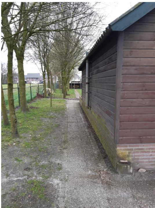
Omschrijving: Asbestverdachte dakbedekking zonder regenwaterafvoer
