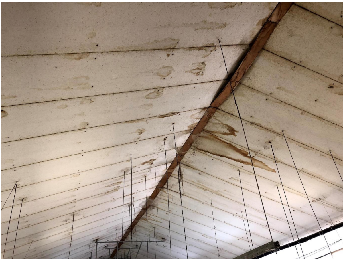
EPS isolatie met waterschade
