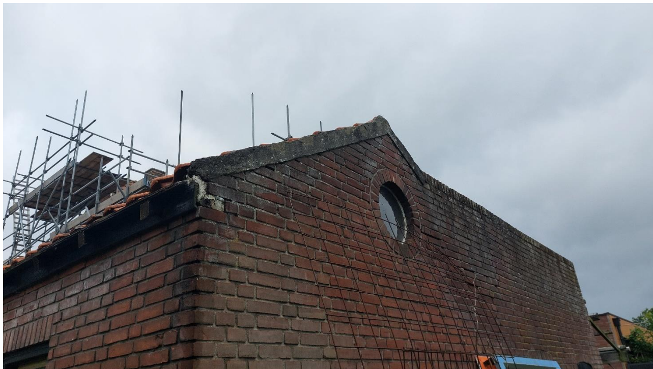
Figuur 4.4.3. De gevelpannen bij de oostelijke kopgevel liggen in de specie.
