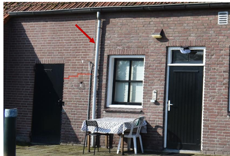
Aansluiting van het oorspronkelijke metselwerk (rechts) en de aanheling met het nieuwe metselwerk van het bedrijfsdeel (rode lijn) de rode pijl wijst de verticale aansluiting van het metselwerk aan.
