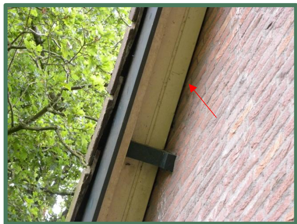
Foto 35: Kierende ruimte langs boeiboord woning (noordzijde).
