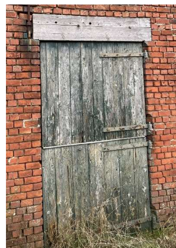
Afbeelding: - slecht schilderwerk houten deur
