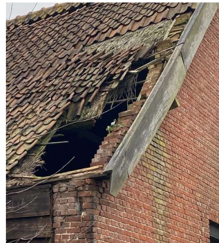
Afbeelding: - weggevalle dakvlak - incomplete houten dakoverstek. - metselwerk topgevel zit los.
