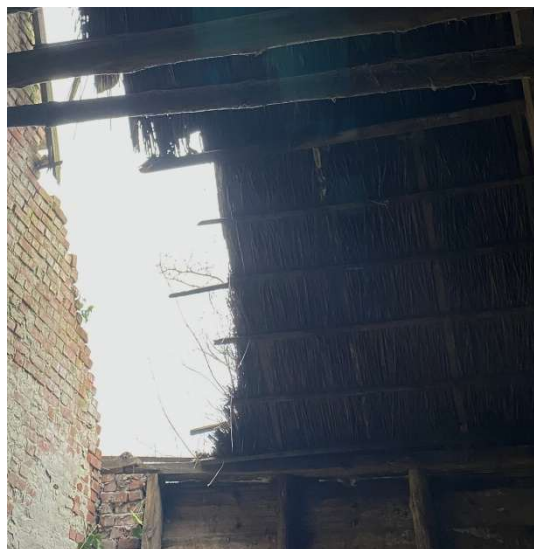
Afbeelding: - ingestort dak en ingerotte muurplaat
