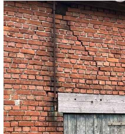
Afbeelding: - scheurvorming in metselwerk. - verroeste ijzer gevelanker.
