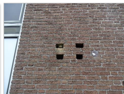
Foto 12: Grote openingen in de muur.
