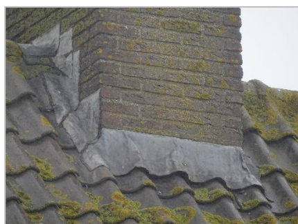
Foto 22: Aansluitende lood op de schoorsteen.
