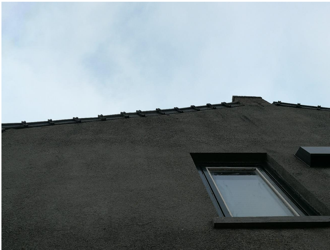
Figuur 9 Dakrand sluit strak aan en is dichtgesmeerd. Geen mogelijkheden voor gebouwbewonende vleermuizen.
