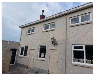
Figuur 5-1. Open stootvoegen aan de zuidzijde van gebouw B
