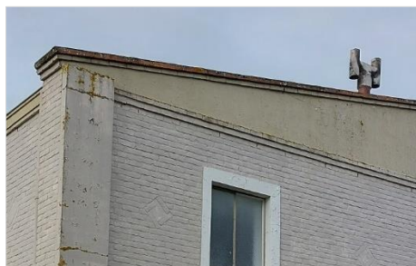
Figuur 5-2. Open stootvoegen aan de oostzijde van gebouw A
