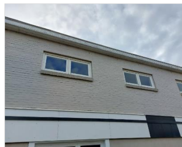
Figuur 5-3. Open stootvoegen bij de entree van de onderzoekslocatie (gebouw B).
