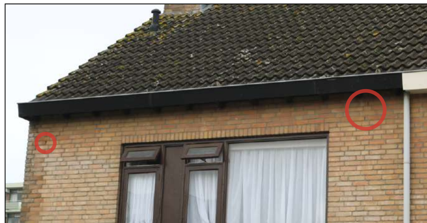
Figuur: open stootvoegen in de woonhuizen aangrenzend aan het plangebied geven toegang tot de spouwmuur. De mogelijk aanwezige verblijfplaatsen kunnen verstoord worden.
