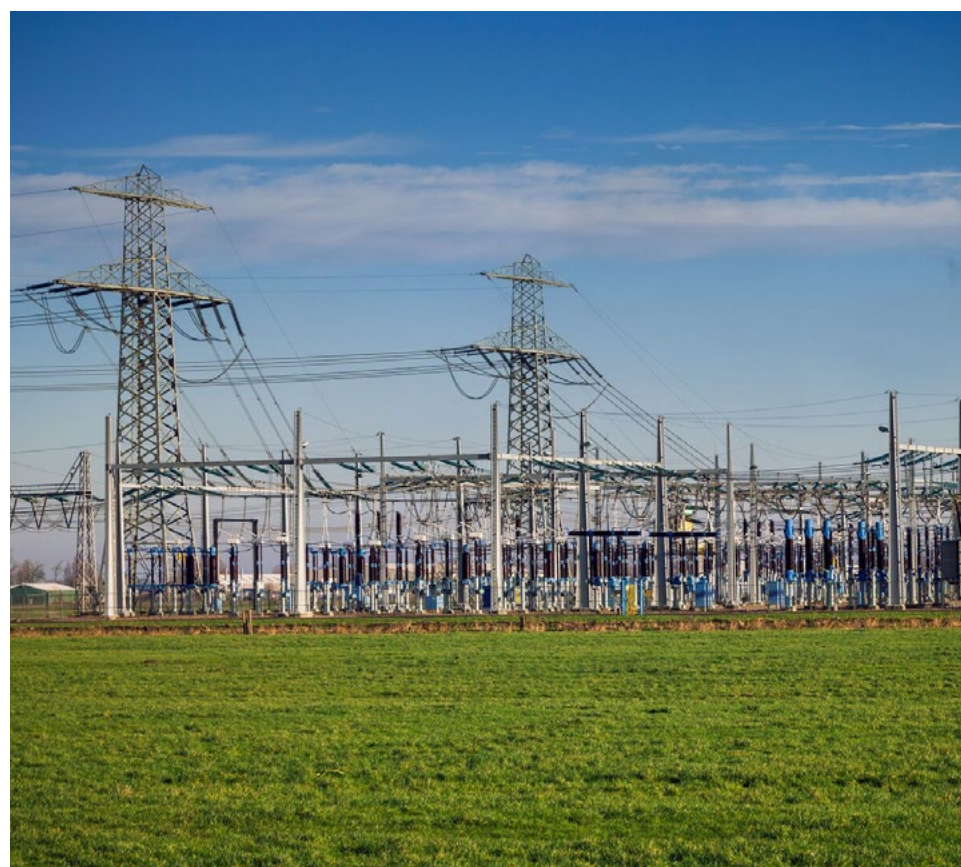
Voorbeeld hoogspanningsstation Viervelaten
