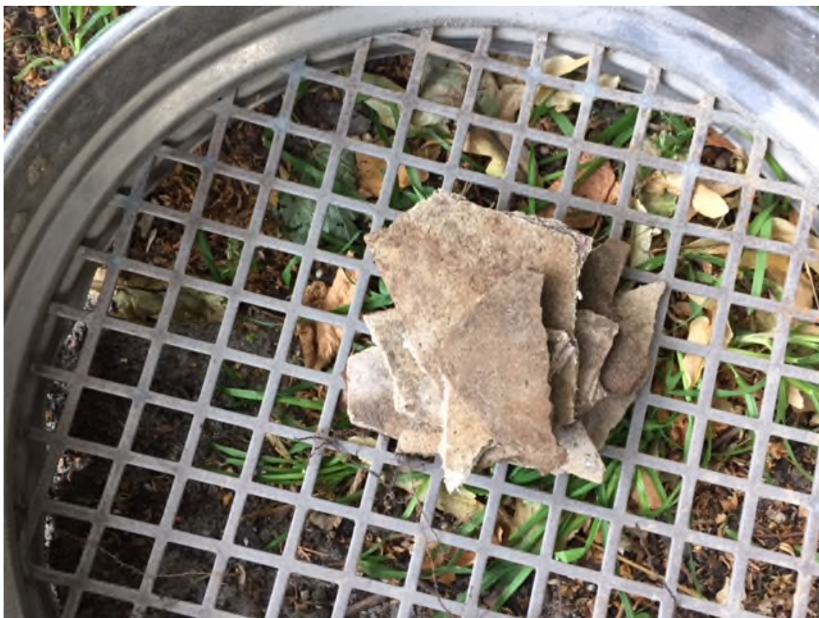
Foto 3: Asbestverdacht bouw materiaal uit sleuf SL001
