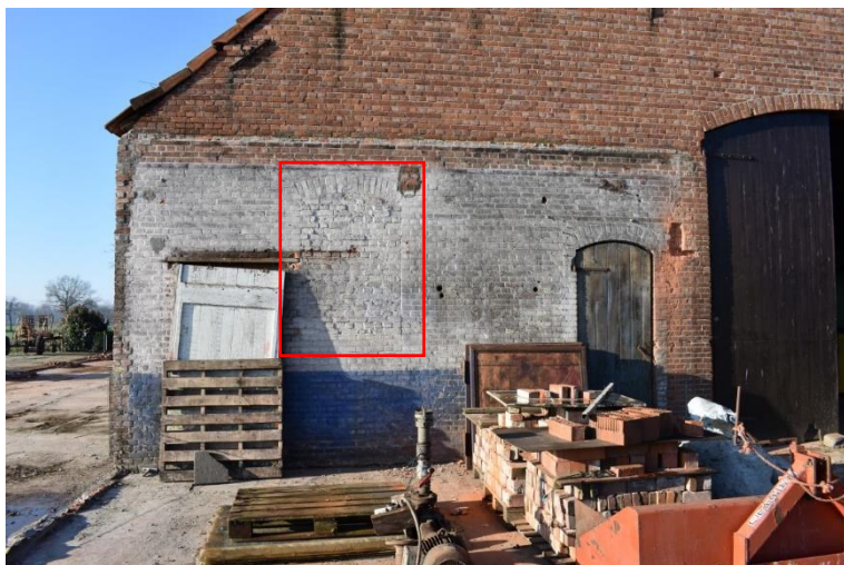
Linkerzijgevel met rood omlijnd een dichtgemetselde vensteropening.
