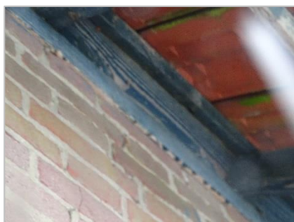
Foto 11: Dakrand westzijde Vlaamse schuur.
