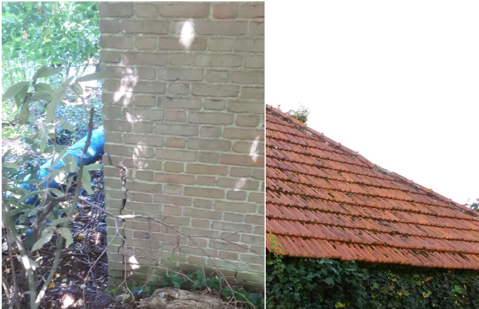
Figuur 15 - (Rechts) brede scheuren in de zuidmuur; (links) verzakking van het dak en kapotte dakvors; deze kapotte dakvors is inmiddels op authentieke wijze gerepareerd.
