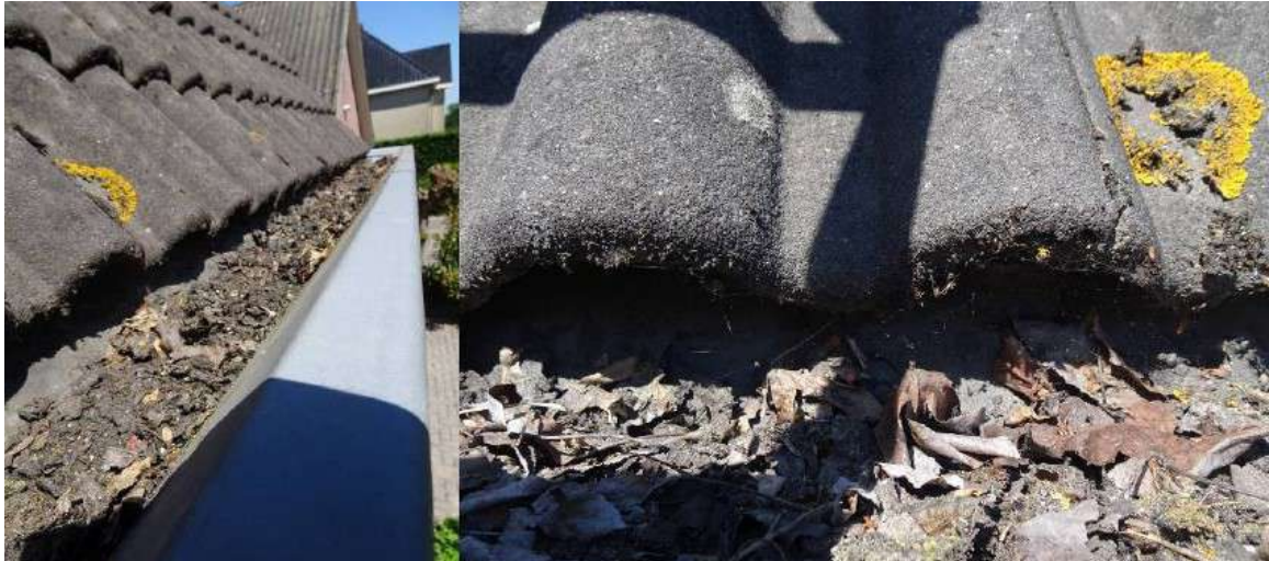
Figuur 9. De onderste dakpannen van de woning aan de Oordeelsestraat 7a te Baarle-Nassau zijn ongeschikt als verblijfplaats voor huismussen of spreeuwen omdat er geen geschikte ruimte is voor nest- of verblijfplaatsen en de dakpannen ver doorlopen tot in de dakgoot (foto; dinsdag 13 mei 2025).
