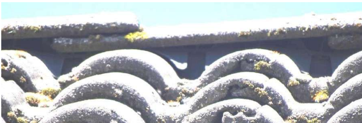
Figuur 11. De nokpannen van de woning aan de Oordeelsestraat 7a te Baarle-Nassau zijn ongeschikt als verblijfplaats voor vogels omdat deze volledig dicht zijn (foto; dinsdag 13 mei 2025).
