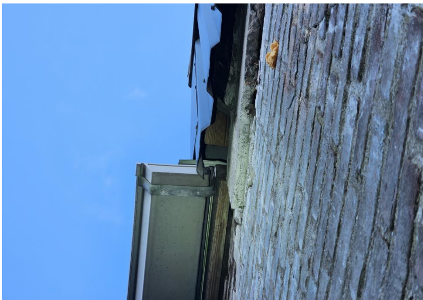
Figuur 12: Kier langs de dakrand van de zuidgevel
