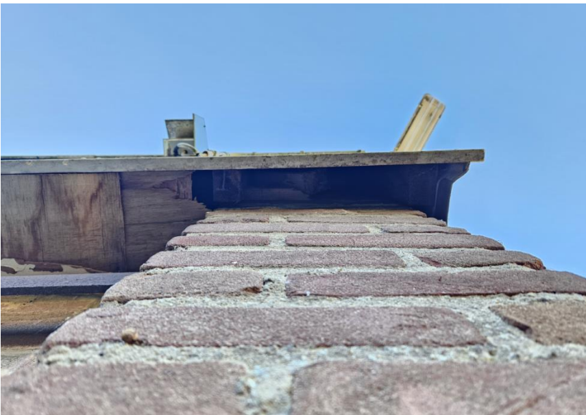
Figuur 17: Kier langs de dakrand van de noordwestgevel
