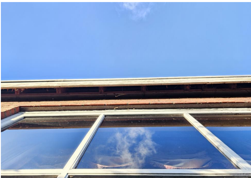
Figuur 13: Kier langs de dakrand van de noordoostgevel
