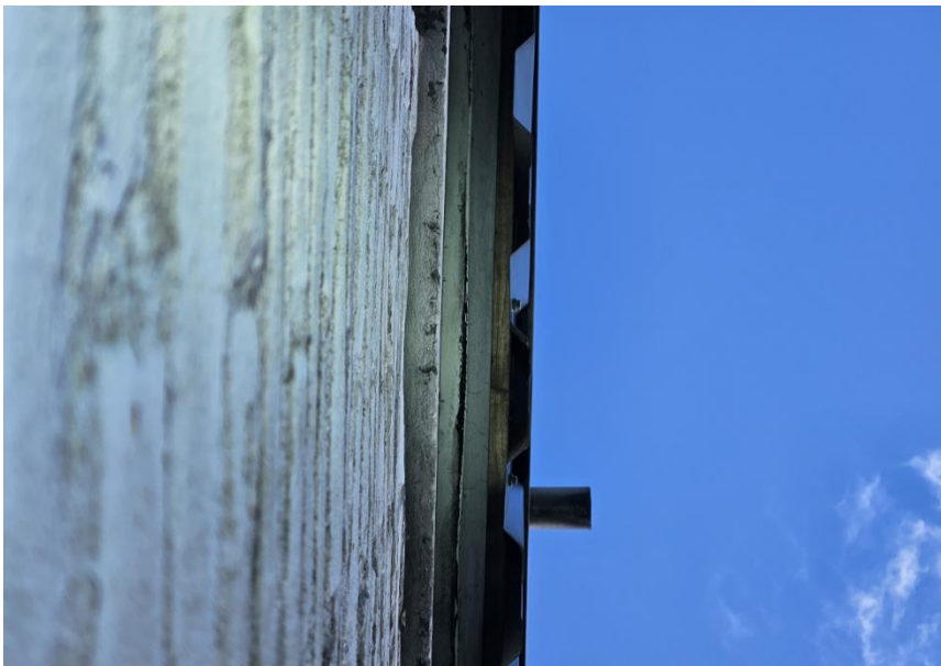
Figuur 16: Kier langs de dakrand van de zuidgevel
