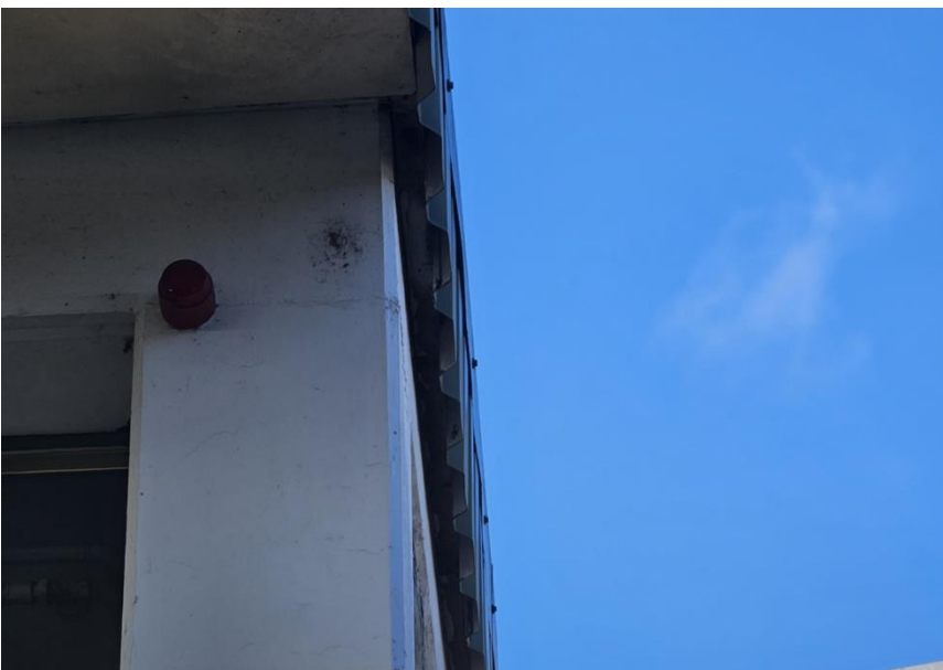
Figuur 14: Kier langs de dakrand van de noordoostgevel
