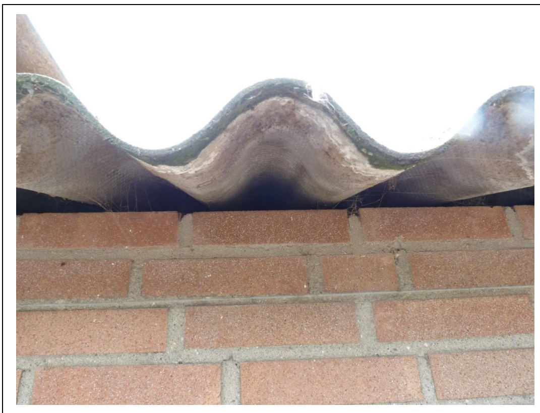
Foto 8. Openingen waar vleermuizen via de bovenzijde toegang hebben tot de spouw.
