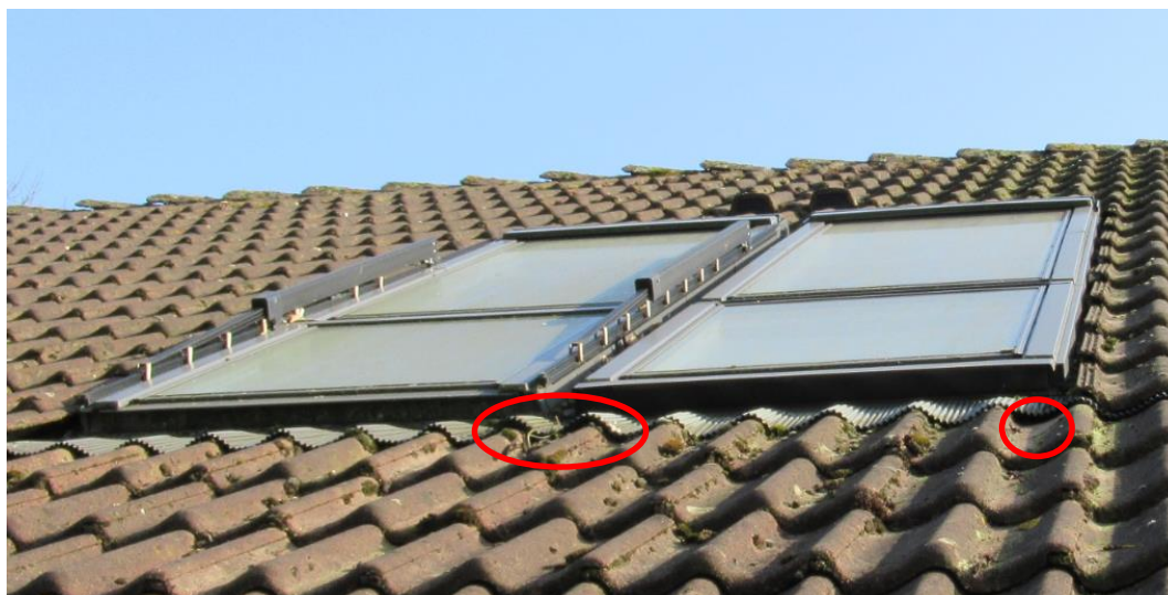
Figuur 4.2. Eén van de dakramen met openingen (rode cirkel)
